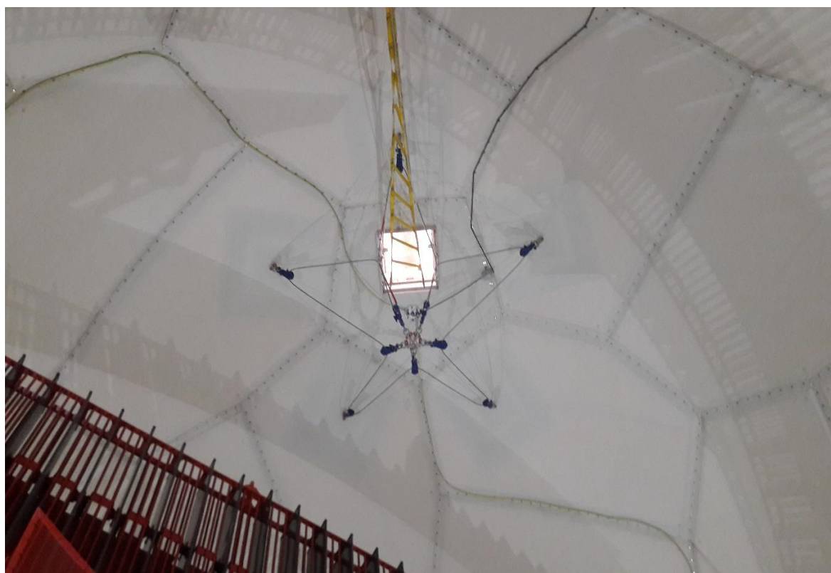
Rysunek 2. . Konstrukcja linowa radar WAM (ASR11)
