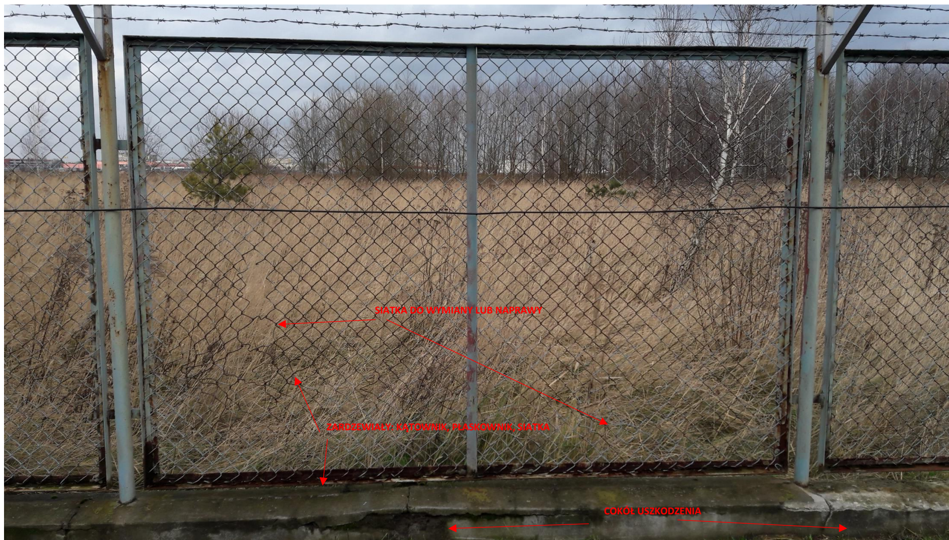
ZDJĘCIE NR 2. - WIDOK PRZESŁA wraz z COKOŁEM - uszkodzenia.
