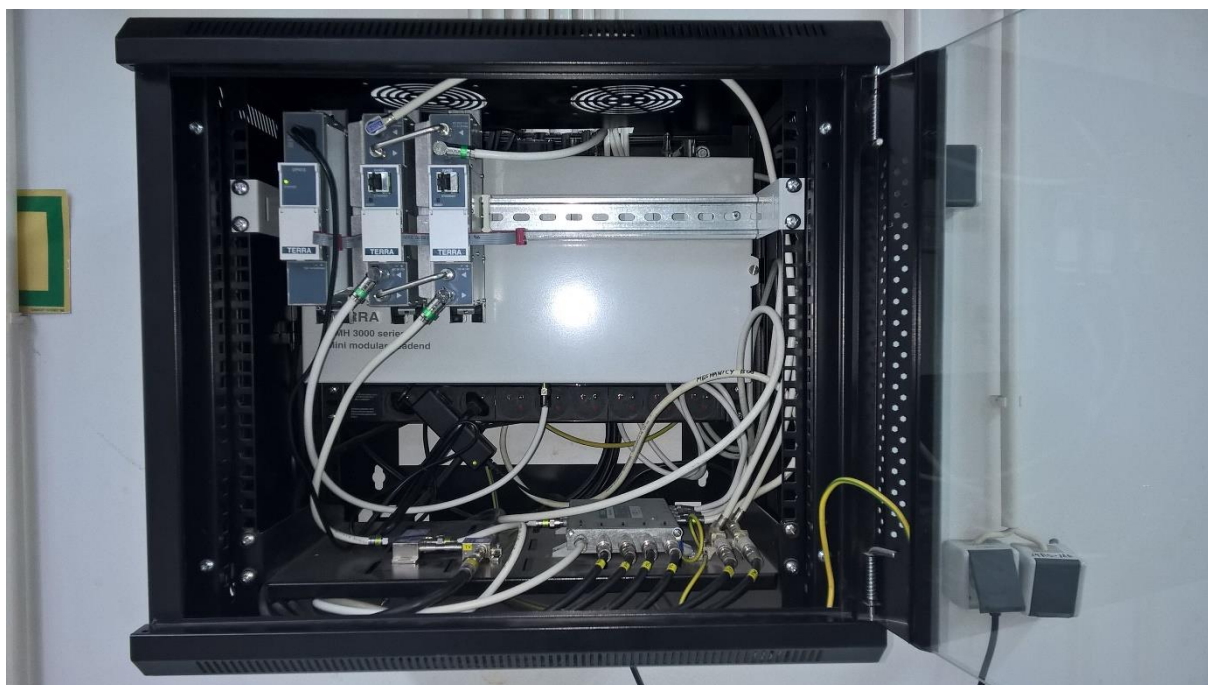
Zdj. Stacja czołowa zainstalowana w maszynowni sektorze E w budynku CZRL PAŹP.
