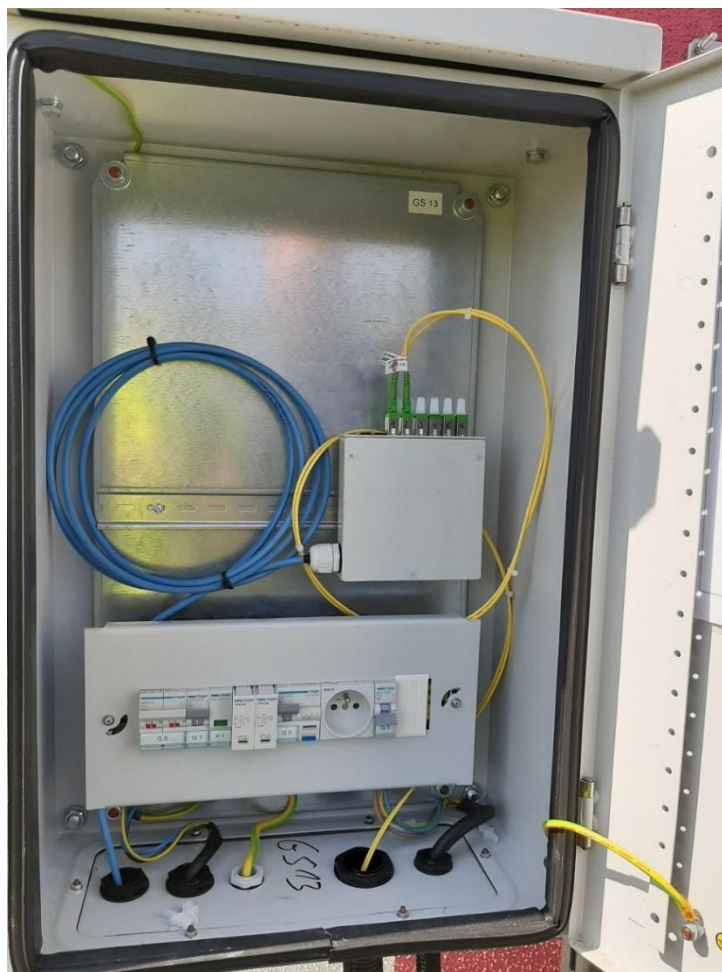
Rys 2 – Szafka przygotowana do montażu licznika wraz z oprzyrządowaniem.
